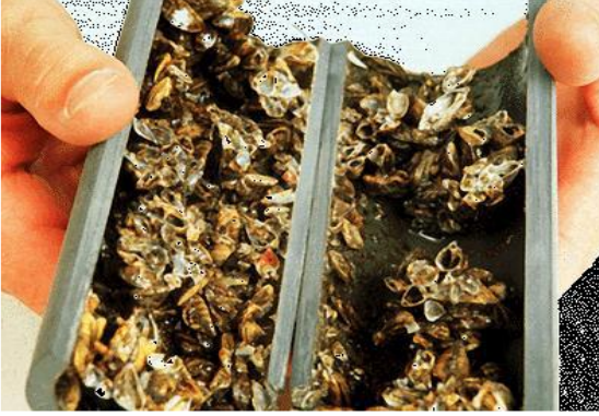
Şekil 1. Su hatlarında birikmiş Zebra midyeler (DSİ, 2012)
