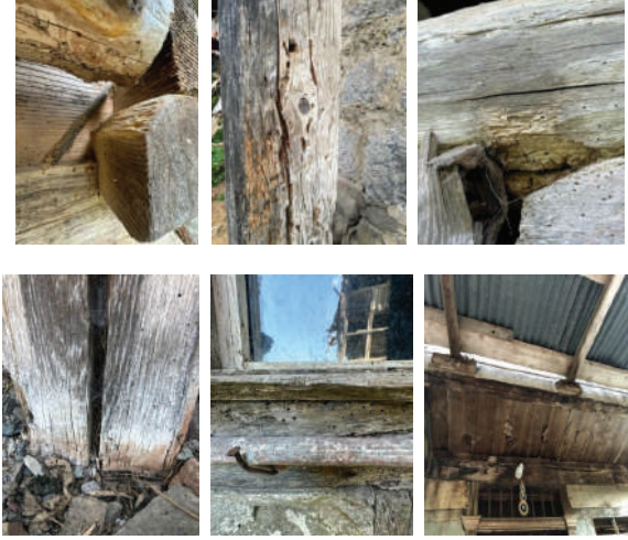
Şekil 9.1. Tarihi ahşap yapılara ait hasar ve kusurlar (a) Ağaç malzemenin taşıyıcı bağlantı yerlerinde çürüme ve böcek yenikleri (b) Ahşap dikmede derin çatlaklar ve böcek tahribatı (c) Taşıyıcı kirişte mantar çürüklüğü ve böcek tahribatı (d) Ahşap dikmede çürüme, böcek tahribatı ve renk değişimi (e) Kirişte böcek tahribatı ve pencere doğramasında renk değişimi (f) Çatı taşıyıcılarında rutubet almaya bağlı oluşan çürüklük ve kusurlar [7]
