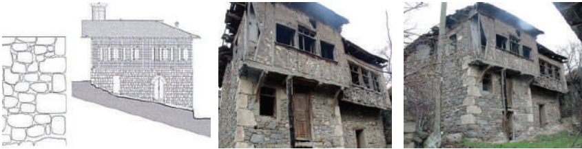
Şekil 4.23. Kagir duvar [37] b) Kagir duvar ev [48]
