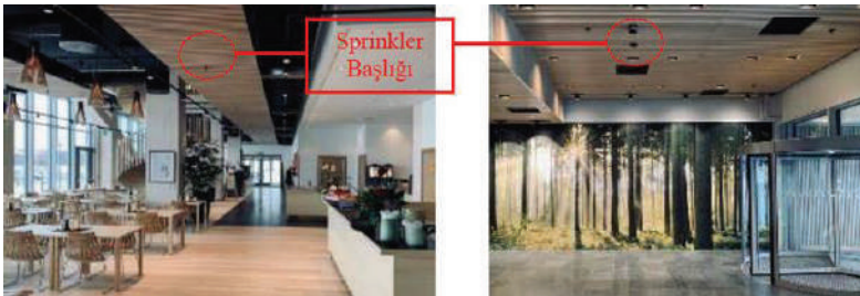
Şekil 12.6. Mjøstårnet yapısında sprinkler sistemin konumu [6]
